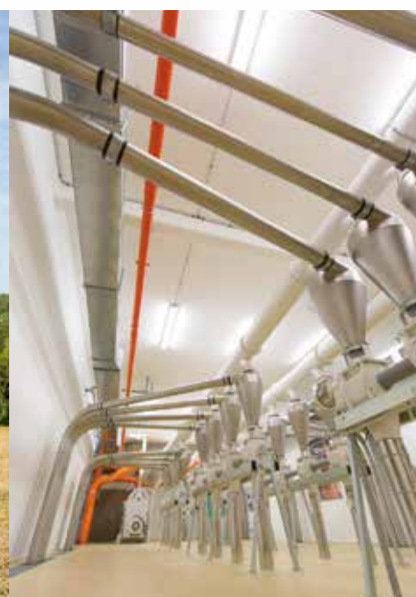
Tuyauterie tout en inox.
